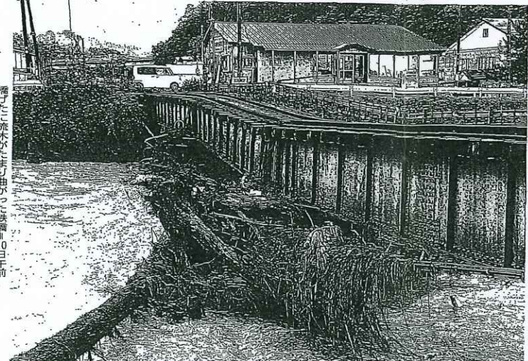
橋げた流水がたり曲がった鉄橋。10日前ごろ、濁り流れた中村川。(撮影:千葉啓介)
